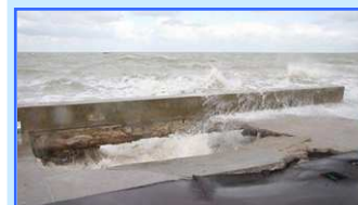
Rupture d'une digue à Asnelles en 2013
